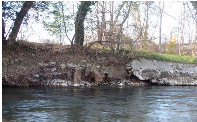
18.11.2005, Marzili, Höhe Gaswerkareal, Uferschutz zerfallen, Ufer unterspült
